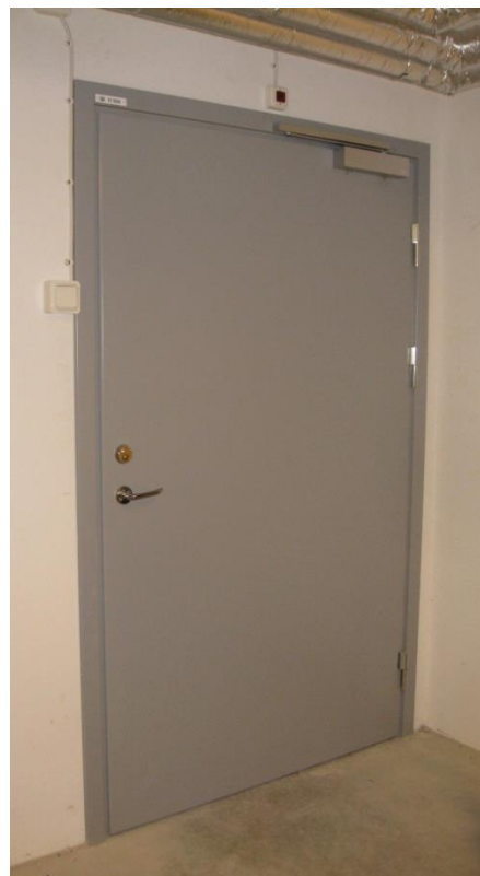
Brandsäker dörr och strömbrytare med kontrollampa på utsidan
