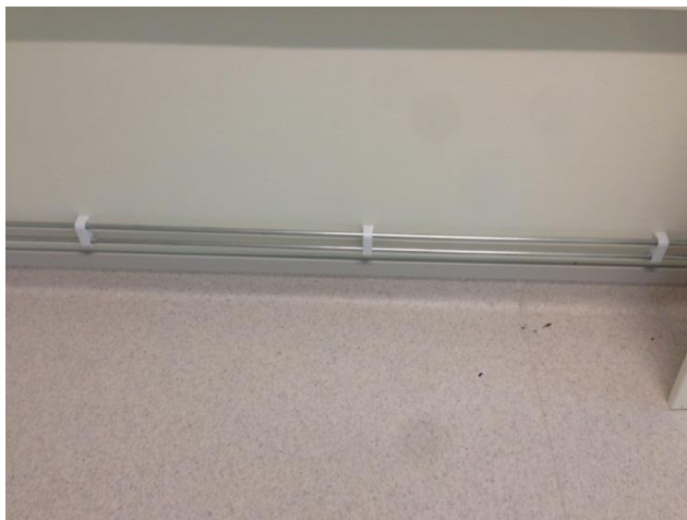
Elförzinkade stålror på vägg klamrade med plastklammer C/C 500 mm. Förskolan Dalbrobranten 4
