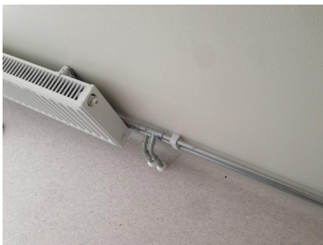
Elförzinkade stålror förlagda bakom radiatorm. Förskolan Dalbrobranten 4.
