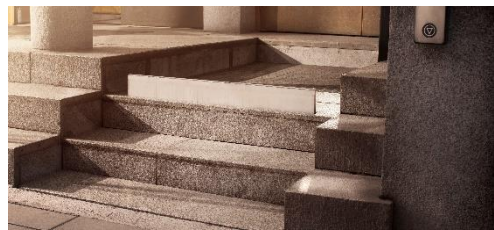
Folkoperan, lyftplattform integrerad i entrétrappan. Foto: Markus Gårder.
