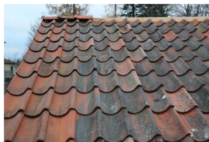
Skadat taktegel kan ersättas med lika befintliga. Foto: Lisa Sundström.
