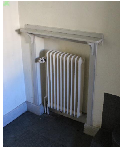
Vasa Real, ursprunglig radiator i nisch. Foto: Fredrik Olsson, AIX.
