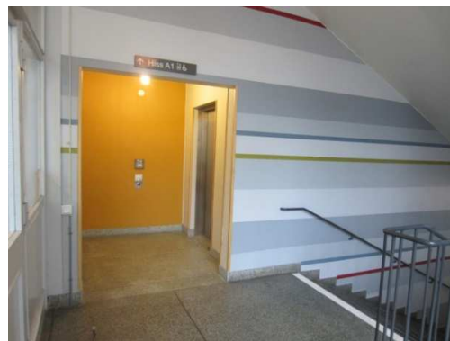
Fruängsskolan. Ledstängerna rår/sticker ut 300 mm framför första och botten sista steg samt tydligt markerad trappnos.
