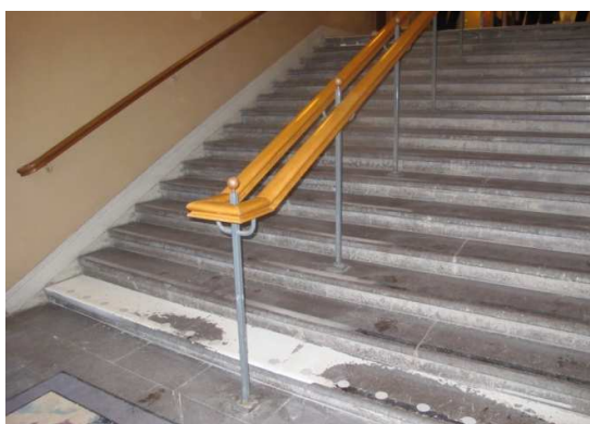
Norra Real. Kontrasterande steg målade, utslitna. Har kompletterats med inborrade vita marmorcyllindrar. Ny ledstång i mitten bred trappa.
