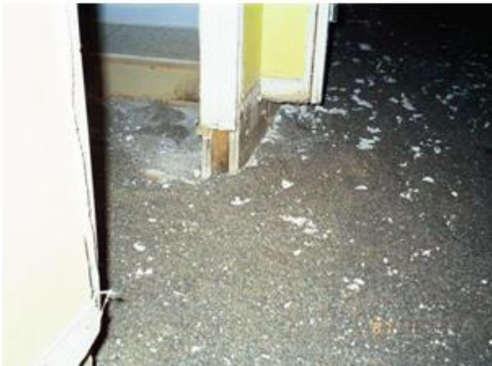
Bild 3 Mellanvägg inkl. gipsskivor i kontakt med sand och befintlig betongplatta
