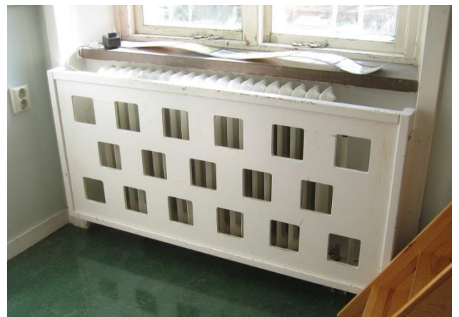
Radiatorskydd heltäckande, klättringsrisk bör beaktas. Möckelvägen 31
