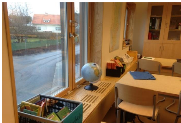
Kombination av bröstningspanel och sockel som bildar fönsterbänk/radiatorskydd. Ursviksskolan
