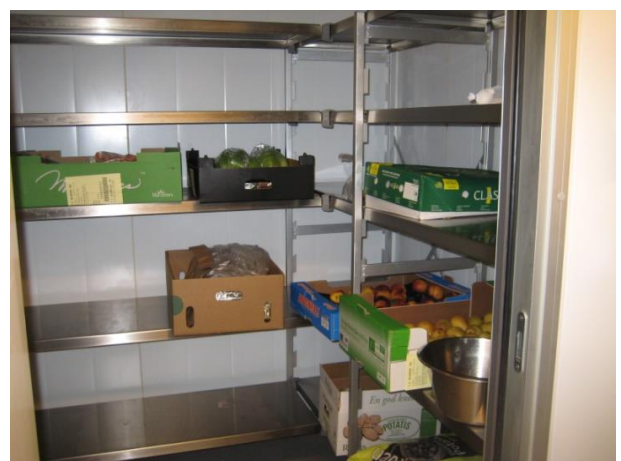
Kylt förråd Östbergabackarna 50
