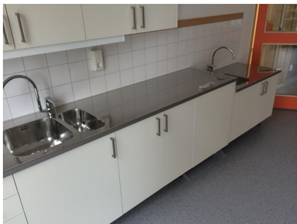
Allrumsinredning, rostfri diskbänk i två höjder. RF-bänk fungerar även som täcksida vid högbankens stomme mot lågbänken. Kanngjutargränd 26
