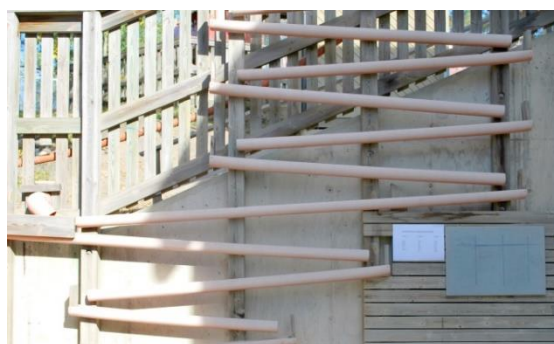
Vattenlek, Nockeby kyrkväg 8
