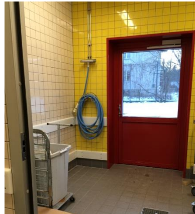
Varumottag med spolslang och golvbrunn
