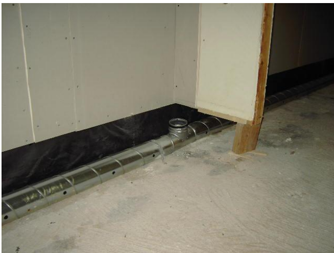
Bild 5 Fördelningskanal där vertikalt spirorör till undertak ska anslutas.
