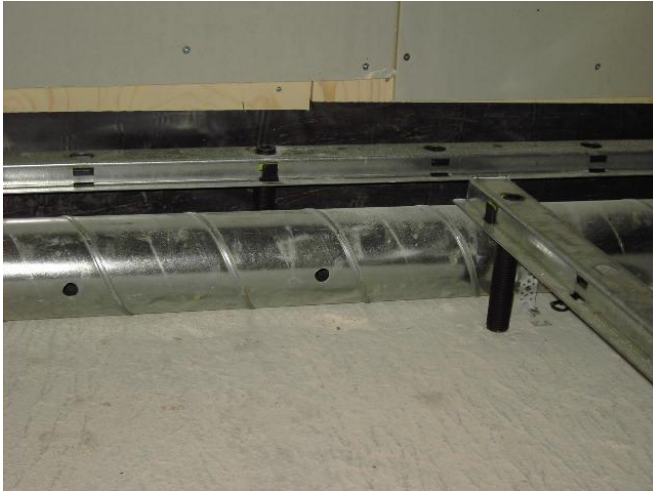
Bild 4 Sugkanal: Spirorör med borrarade hål.
