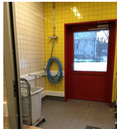
Varumottag med spolslang och golvbrunn
