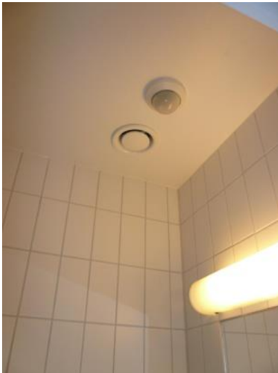
Exempelbild 11. Extern närvarogivare för styrning av belysning och avstängning av vatten.
