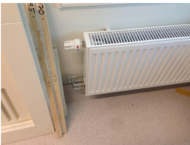
Anslutning till radiatorm med stålror förlagda bakom radiatorm. Förskolan Dalbrobranten 4.
