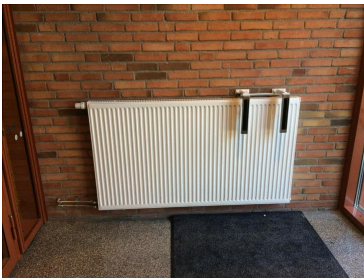
Radiator sidoansluten med elförzinkade stålrör. Lugnets skola entré.
