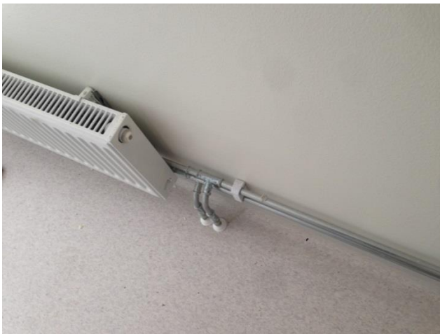
Elförzinkade stålror förlagda bakom radiatorm. Förskolan Dalbrobranten 4.
